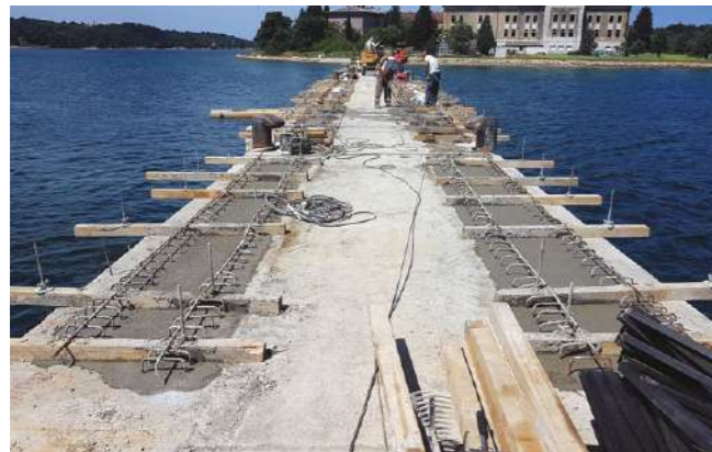
Izvedba armirano betonskih pilota s postojećeg mosta Construction of reinforced concrete piles from the existing bridge
